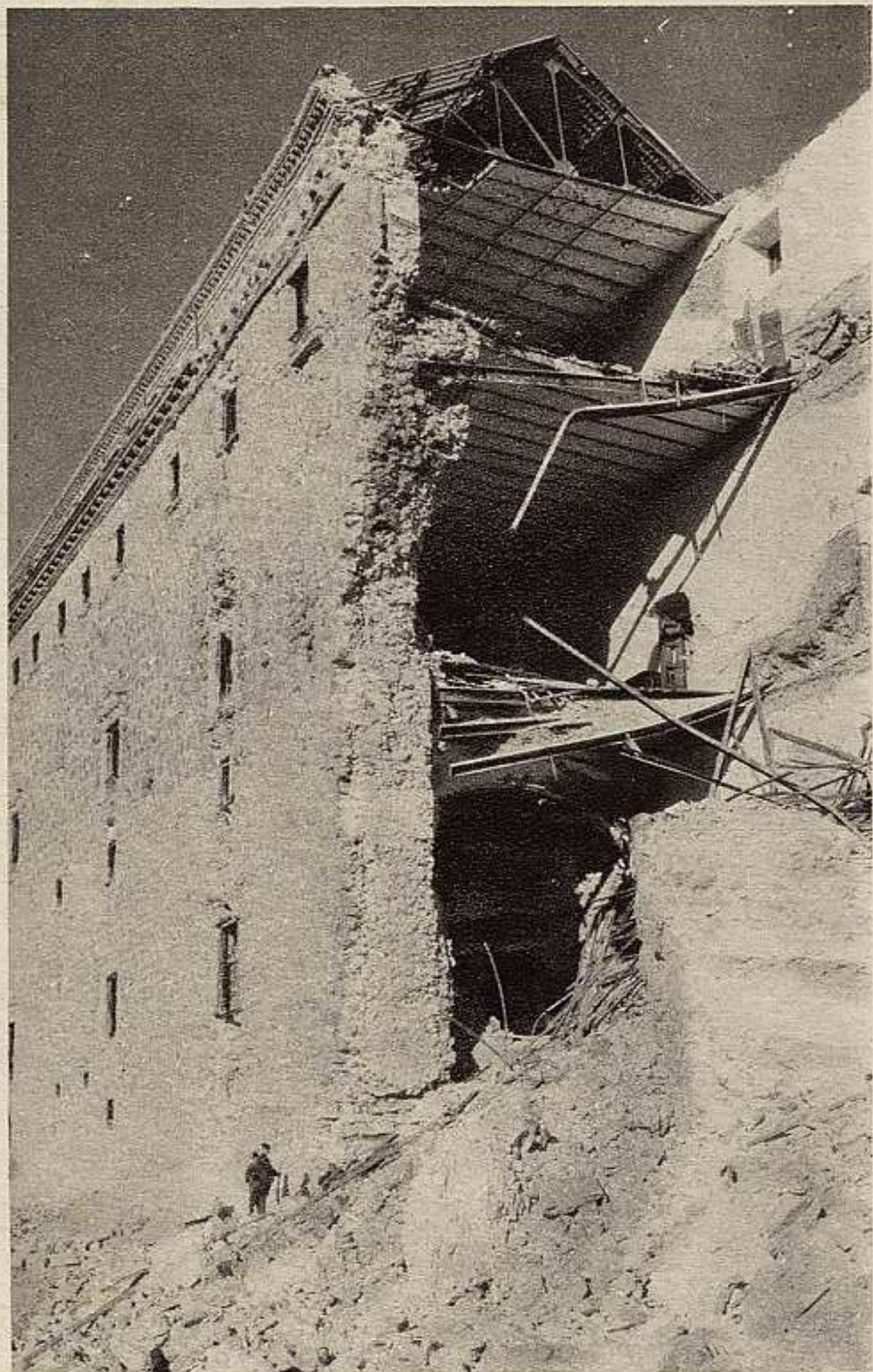
Núm. 9. Lo que ha quedado de la fachada Oeste.
