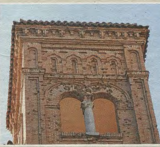
Impactos de metralla en el torreón y detalle de la puerta cerrada
