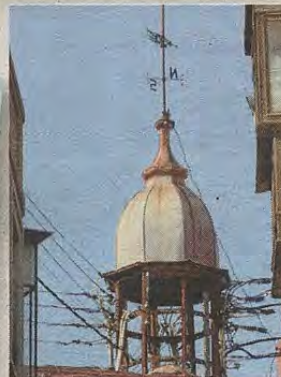
Remate superior del transformador. (R. del Cerro)
