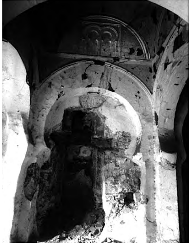
Fig. 3. Aspecto que tenía en 1951 la chimenea y el revoco del luneto sur de la bóveda sureste. (Casa Rodríguez, Biblioteca Digital de Castilla-La Mancha).
